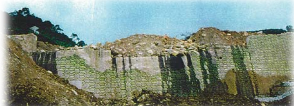
計画規模以上の土石流を受けたが倒壊せず 減災効果を発揮した堰堤 (鹿児島県出水市針原地区)
