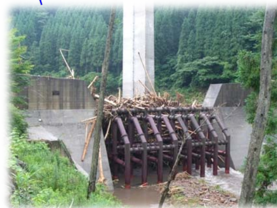
透過構造による流木捕捉(熊本県小国町)
