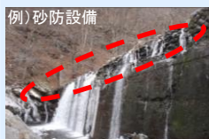
例) 砂防設備 水通し天端の摩耗の進行 砂防堰堤の天端摩耗による堰堤の土砂捕捉機能低下
