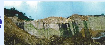
計画規模以上の土石流を受けたが倒壊せず減災効果を発揮した堰堤 (鹿児島県出水市針原地区)
