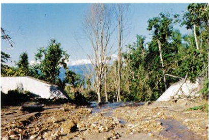
国道の沢No.1谷止工 (53.8.17) 緊急治山で上流に谷止工を設置した ので、国道から約50mのこの地点で 流出土砂はくいとめられている。
