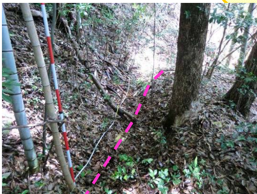
②不安定化した斜面 (連続する凹状の地形)
