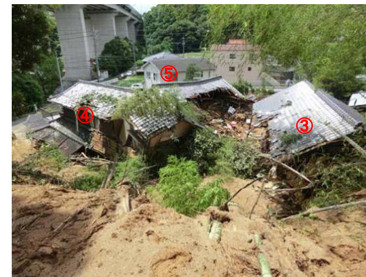
④がけ崩れにより被災した人家
