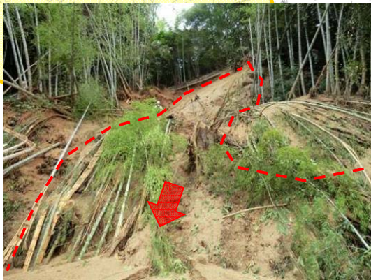
③崩壊した斜面の様子
