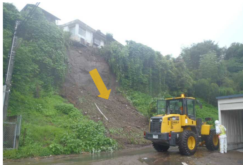
①斜面崩壊状況
