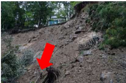
②崩壊状況
