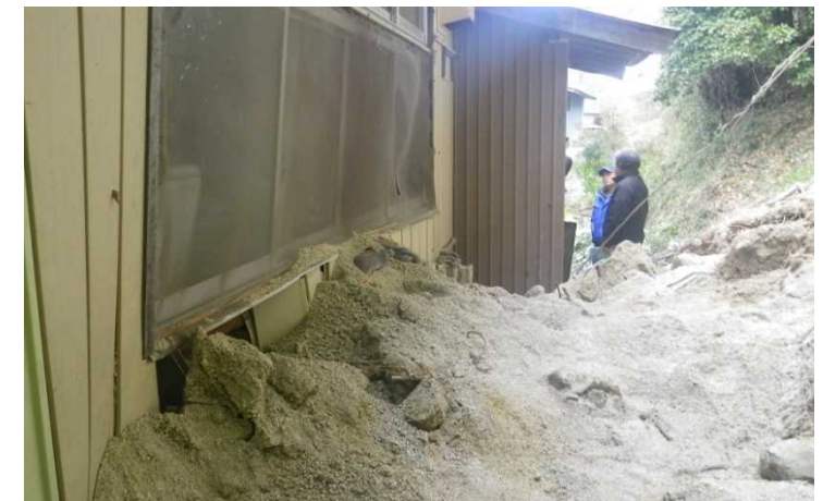
③家屋の被害状況
