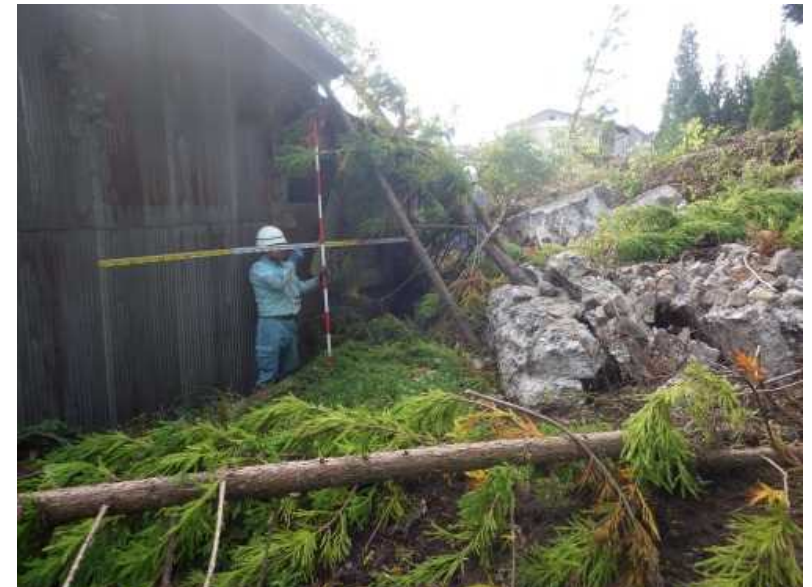
③家屋の被害状況
