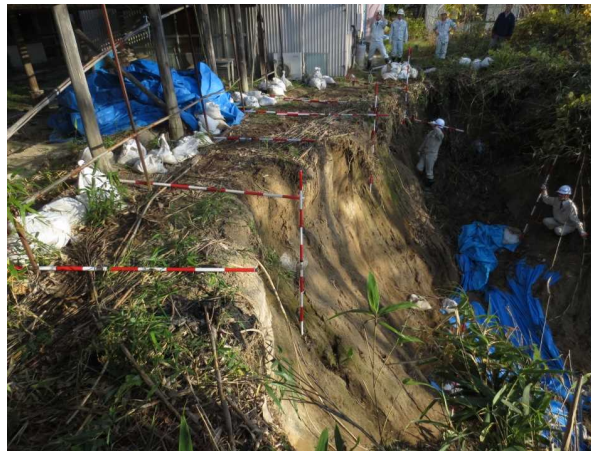
②斜面崩落状況
