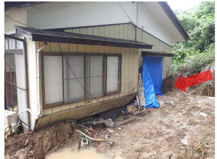
③家屋の被害状況
