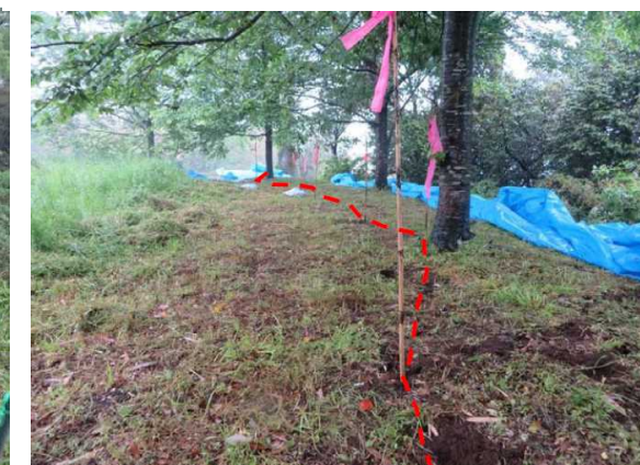
③斜面の亀裂状況
