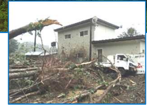
家屋一部損壊1戸
