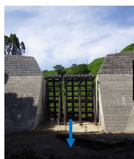
土石流発生前 (H28.6.1撮影)
