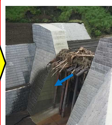
土石流発生直後 (H28.7.2撮影)
