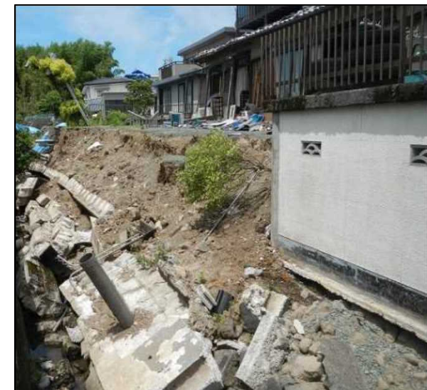
人工斜面崩壊状況（熊本県益城町）
