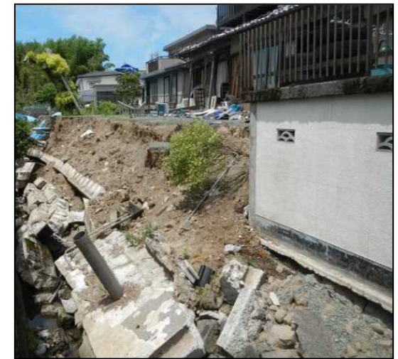
人工斜面崩壊状況(熊本県益城町)
