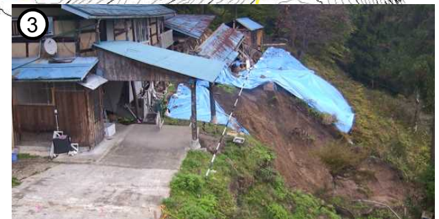
家屋被災状況
