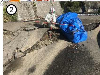
村道1号の亀裂段差
