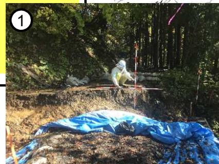
村道1-33号の亀裂段差
