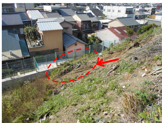
がけ崩れ発生直後 (H29.6.23)
