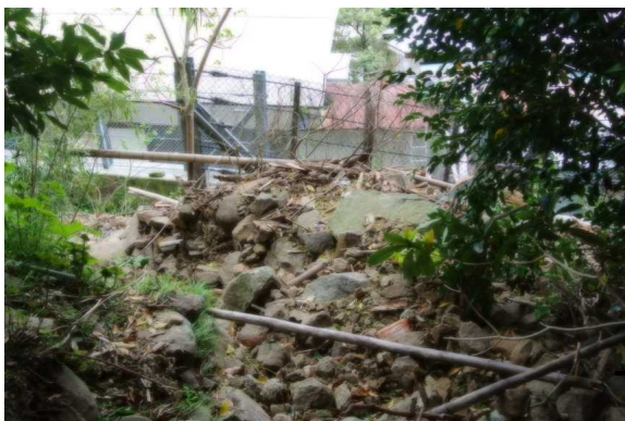
がけ崩れ発生直後 (H29.4.21)
