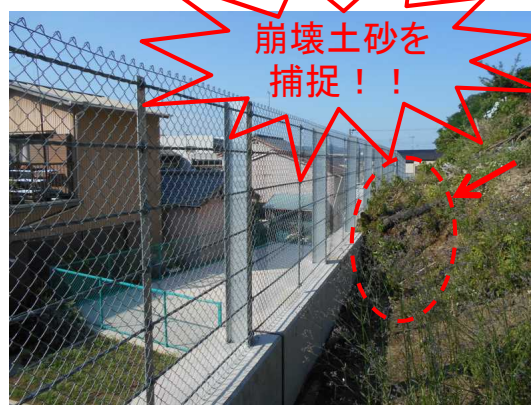
がけ崩れ発生直後 (H29.6.23)
