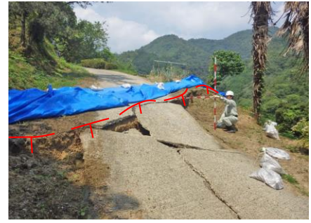
②私道の被災状況 (A-2ブロック)
