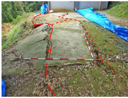
①頭部の滑落崖の状況 (A-2ブロック)
