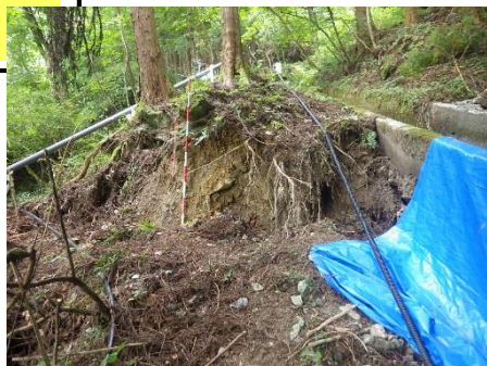
①地すべりブロック頭部の滑落崖
