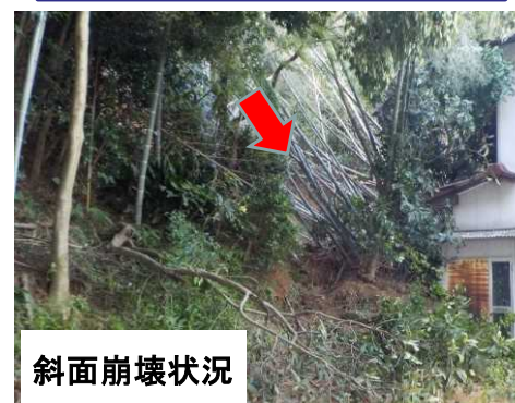
斜面崩壊状況
