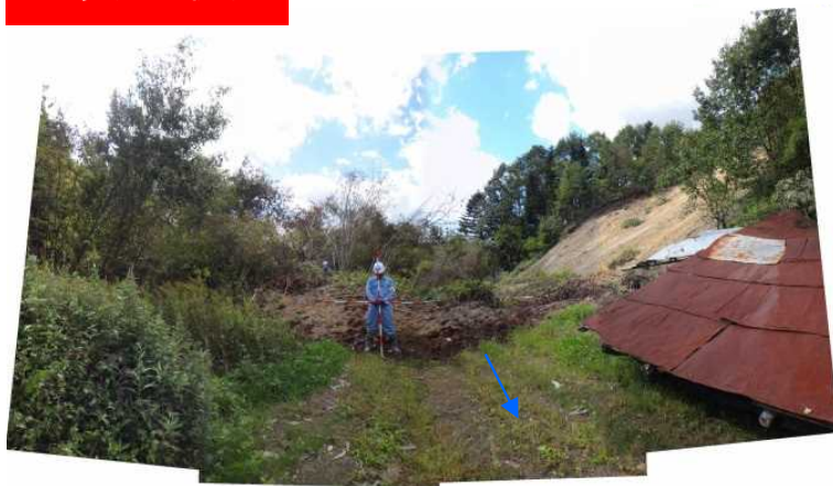
土砂流出状況
