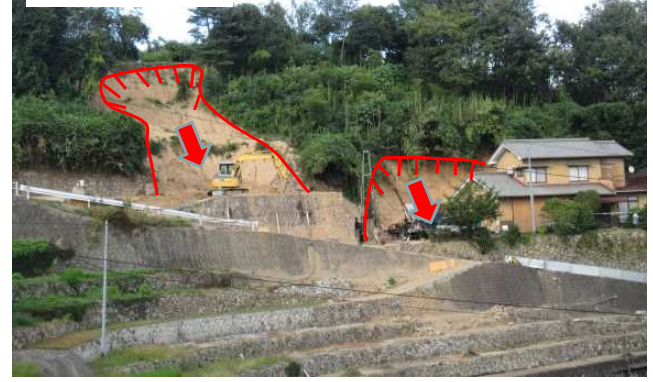
斜面崩壊状況
