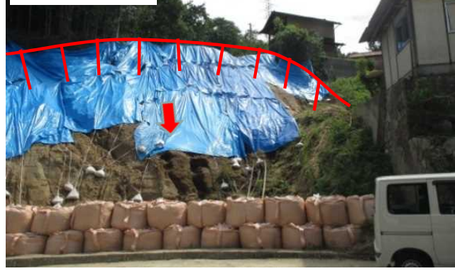
斜面崩壊状況
