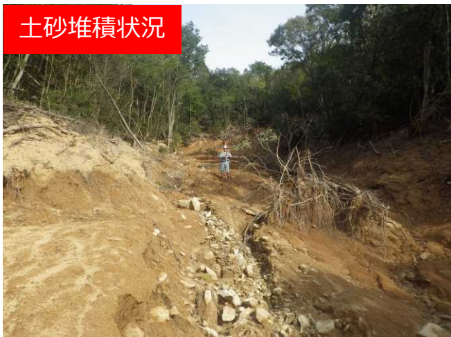
土砂流出状況
