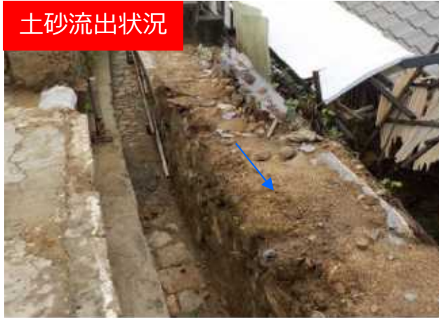
土砂流出状況
