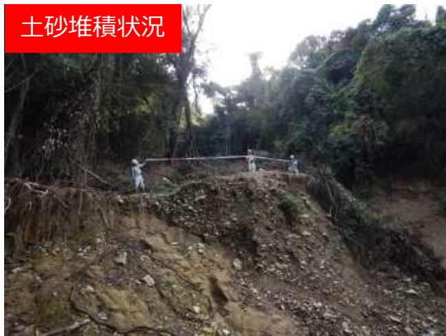
土砂流出状況
