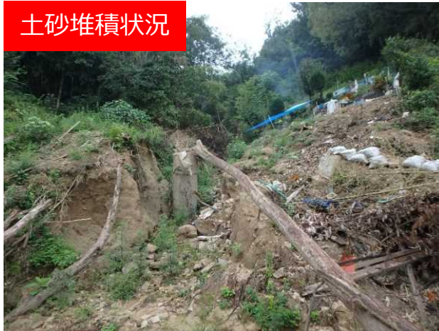
土砂流出状況
