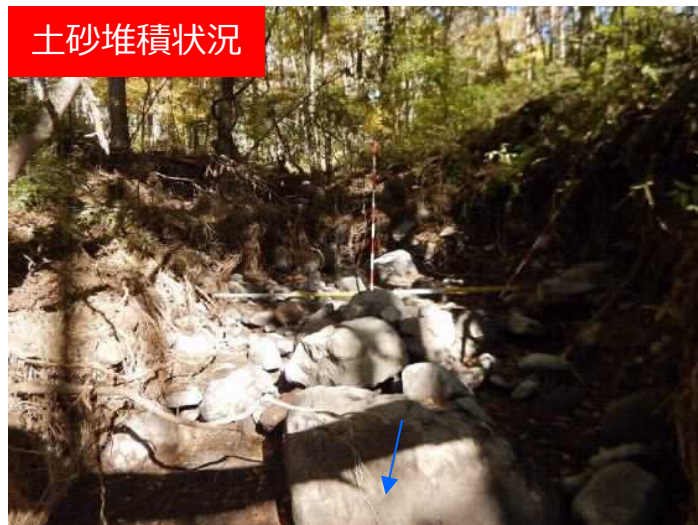
土砂流出状況
