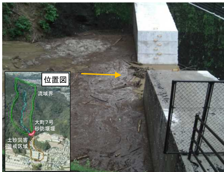
土石流の捕捉状況 おおまち (大町7号砂防堰堤) (高さ9.0m、長さ32.0m)
