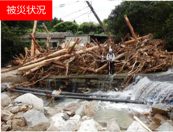
土砂堆積状況
