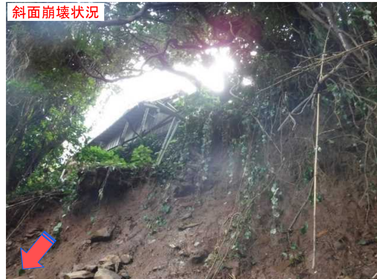
斜面崩壊状況
