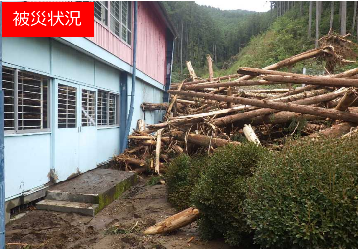
不安定土砂堆積状況
