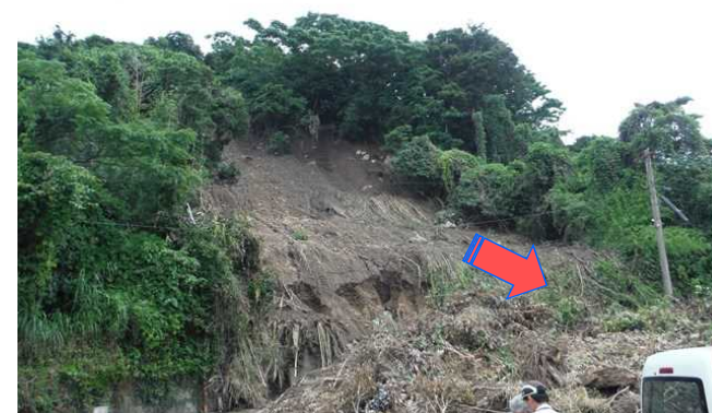
斜面崩壊状況
