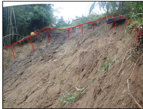
被害状況①(滑落崖の状況)
