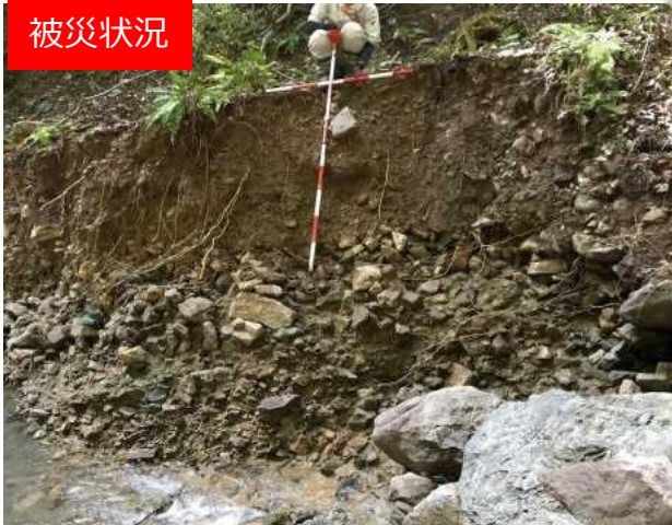
不安定土砂堆積状況
