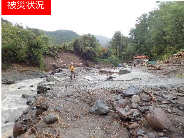
不安定土砂堆積状況
