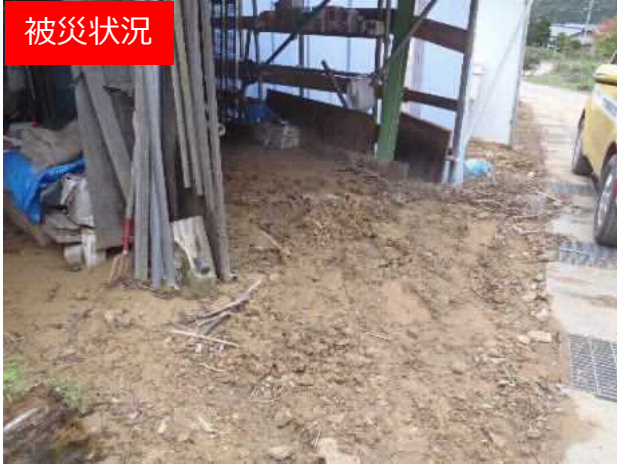
不安定土砂堆積状況
