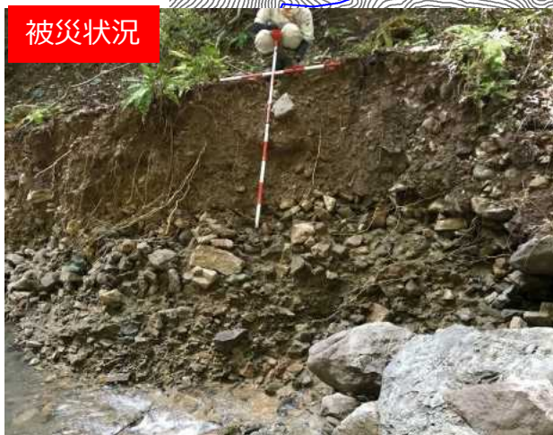
不安定土砂堆積状況
