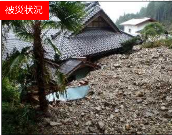
不安定土砂堆積状況
