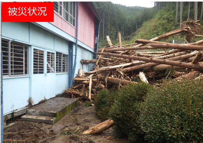
不安定土砂堆積状況
