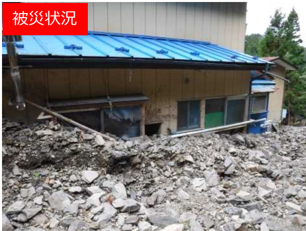
不安定土砂堆積状況
