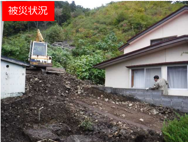
不安定土砂堆積状況
