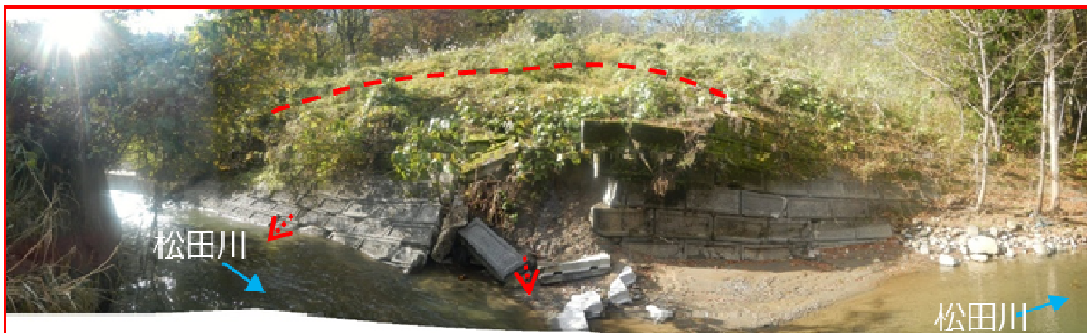
既設護岸工の被災(末端部)
