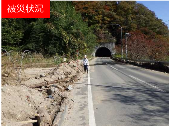
不安定土砂堆積状況
