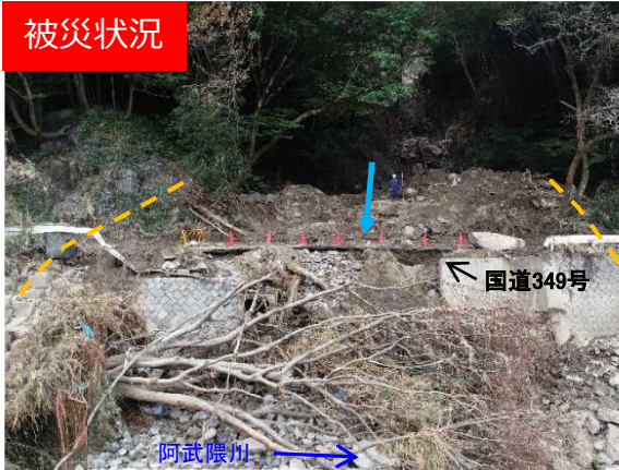
不安定土砂堆積状況
