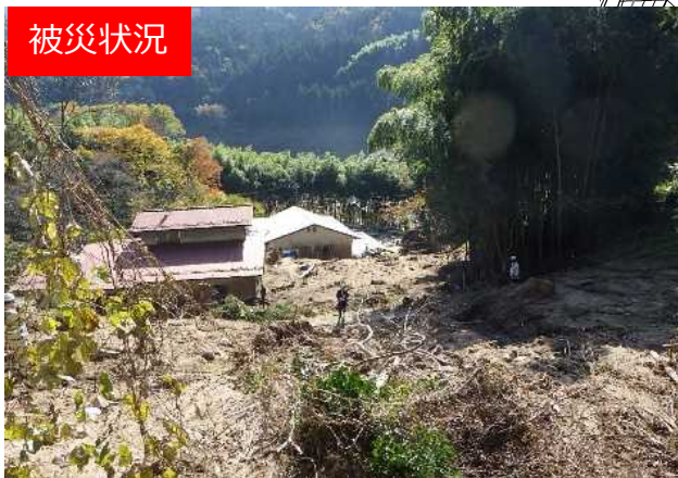
不安定土砂堆積状況
