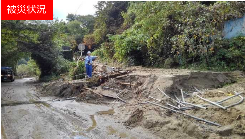
不安定土砂堆積状況
