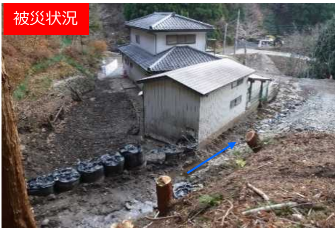
不安定土砂堆積状況
