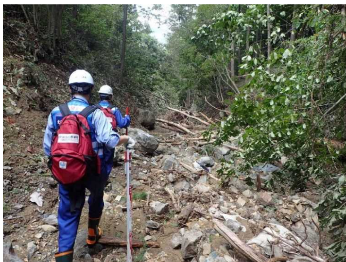
被災状況調査 【長野県長和町】 (北陸地方整備局)
