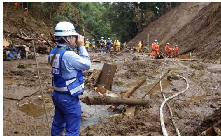
土砂崩れ現場調査 【神奈川県相模原市】 (九州地方整備局)
