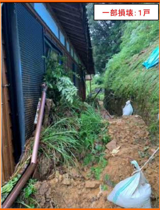
8/27 8/27 8/27 がけ崩れ 長崎県佐世保市鹿町町直谷
