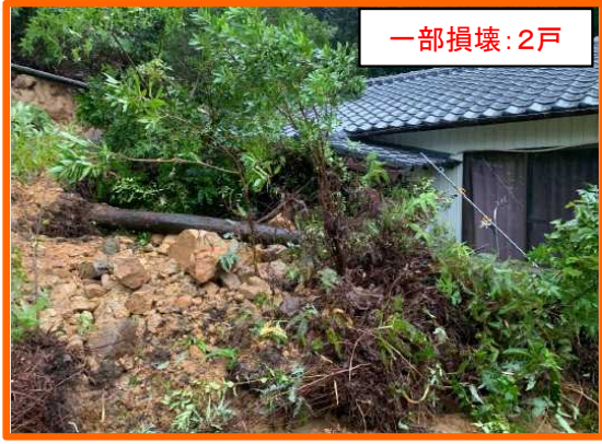
8/27 8/27 8/27 がけ崩れ 長崎県佐世保市鹿町町下歌ヶ浦
