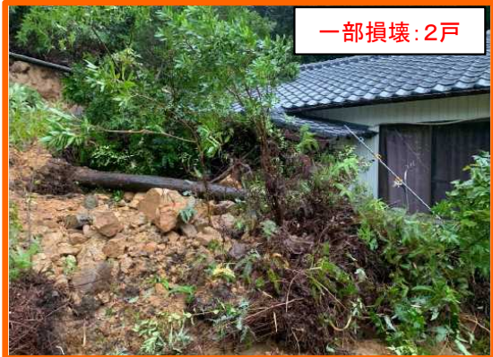
8/27 させぼ しかまちちょう しもうたがうら がけ崩れ 長崎県佐世保市鹿町町下歌ヶ浦
