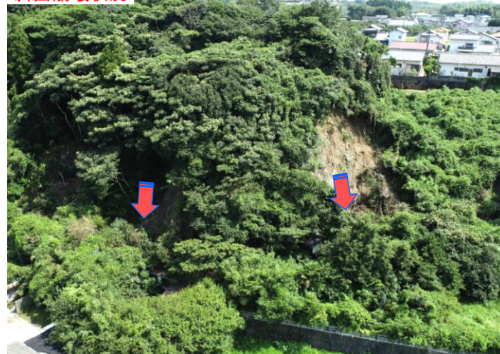
斜面崩壊状況
